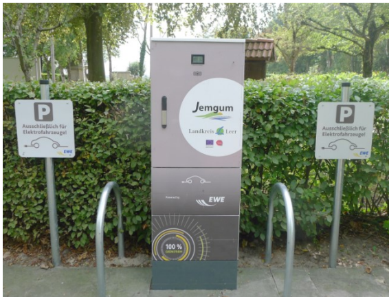
Die Stromtankstelle auf dem Parkplatz vorm Rathaus. Foto: G. Kronsweide
