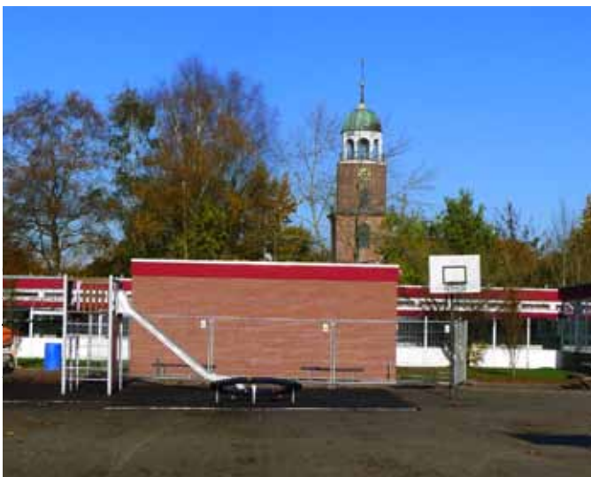
Zwei Zustandsaufnahmen der Renovierungsarbeiten am mittleren Südflügel während der Bauarbeiten und nach der Fertigstellung. Blick nach Norden. Fotos: G. Kronsweide
