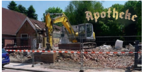
Zuletzt stand nur noch der Anbau mit dem Fotoladen. Foto: G. Kronsweide 28.5.2023.
