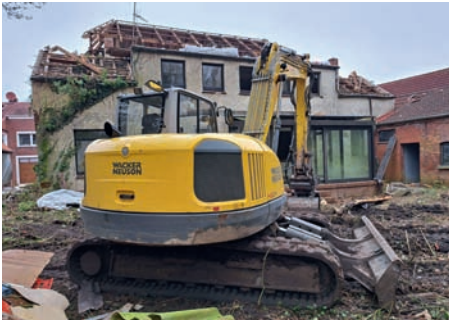
Der Bagger hat erste Spuren auf der Rückseite hinterlassen. Foto: H. Szyska RZ 11.4.2023.
