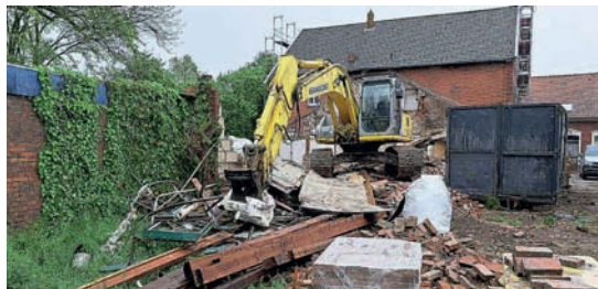
Der Abrissbagger hat den Saal „plattgemacht“ und hat noch den hinteren Anbau vor sich (Foto: H. Syska RZ 11.5.2023).
